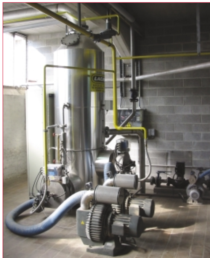
De ketel is geconstrueerd voor een continue warmwaterproductie van 15 m 3 /h met als eindtemperatuur 70°C.
